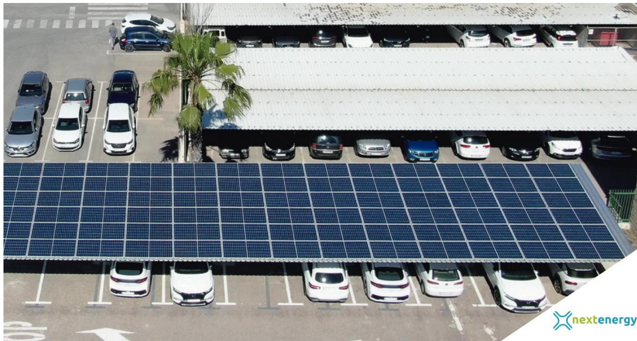
Fig 99. Ejemplo de paneles fotovoltaicos en aparcamiento. Fuente: Nextenergy
