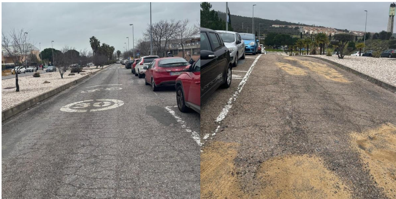
Fig 23. Estado del pavimento analizado en las vías mencionadas. Fuente: Elaboración propia
